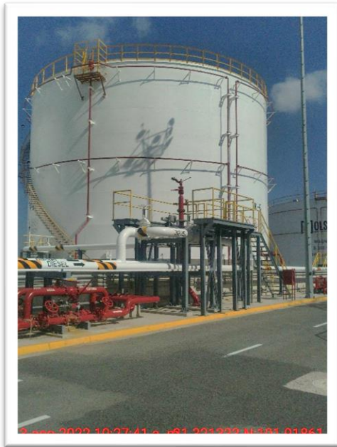
Figura 47. Sistema vs incendio (rociadores en tanques)
