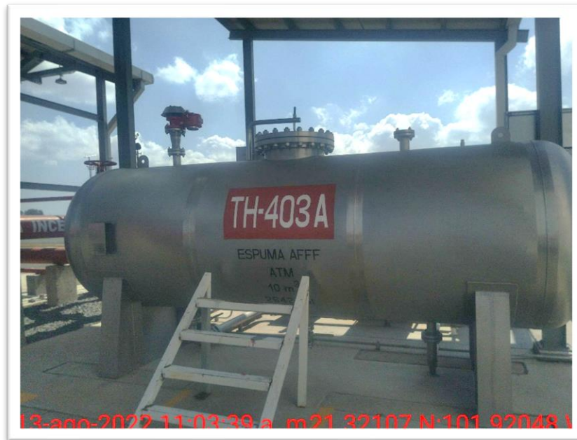
Figura 55. Tanque FFF espuma
